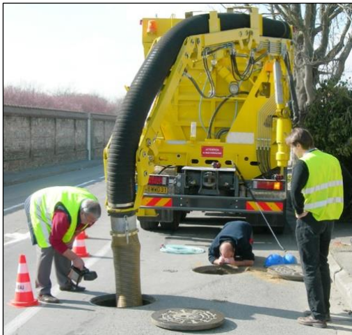
Spülwagen bei der Kanalreinigung (beispielhaft)
